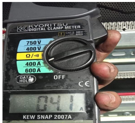
Gambar 8. Pengukuran arus pada keluaran MCB
