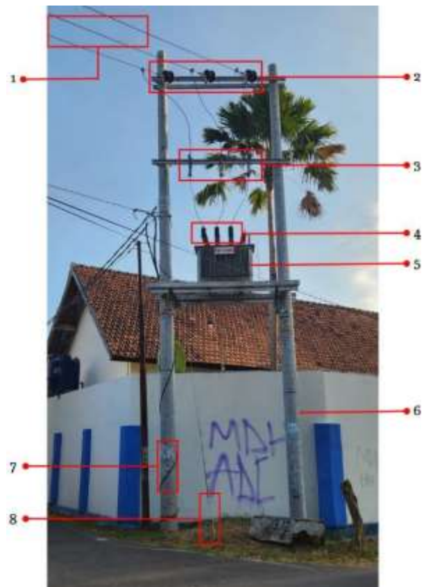
Gambar 4 Konstruksi Gardu Distribusi T16- 21 penyulang PLR-16.
