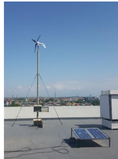
Gambar 2. Foto Dokumentasi Turbin Angin dan Panel Surya di rooftop P7 Universitas Kristen Petra
