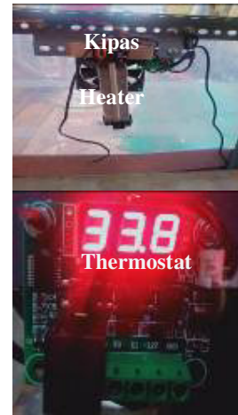
Gambar 14 Implementasi sistem di ruang pengering
