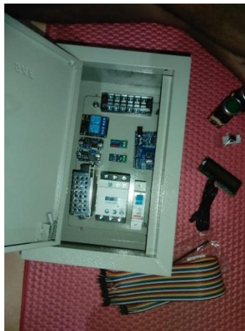
Gambar 5 Penempatan komponen pada box panel kontrol
