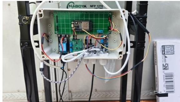
Gambar 6. Box Kontrol Sistem
